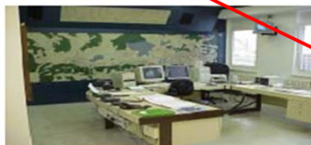
Dispečerski center na Koroški 3a-PE Energetika
